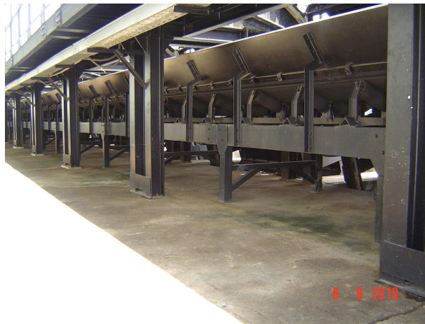
ภาพที่ ๑๖ บริเวณภายนอกสถานีสูบน้ำ ได้สายพานเครื่องเก็บขยะ มีความสะอาดเรียบร้อย ดีขึ้นกว่าก่อนทำโครงการฯ เป็นอย่างมาก
